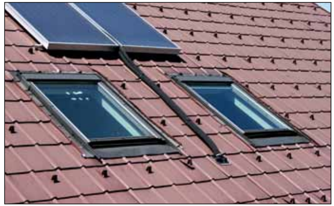
Alle schrägen Dachfenster (8 insgesamt) haben in den letzten Jahren durch das harte Klima in der Weise gelitten, dass sie jetzt unbedingt ersetzt werden müssen.
