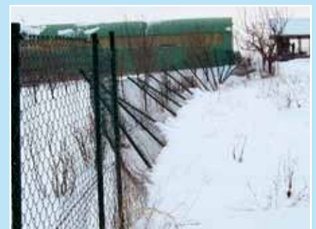
Auf unserem Grundstück wurden fast alle Zäune samt Betonsockel durch den Sturm beschädigt oder niedrigerissen.
