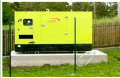
Unser neuer Notstromgenerator steht schon in Dorohoi auf dem HCI-Gelände
